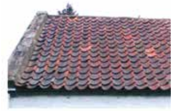
בעל חתך רוחב דמוי האות S. מוכר בהולנד וסקוטלנד מאז המאה ה-17. מקנה לגג טקסטורה של גלי ים.
